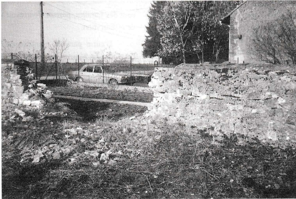
Etat du mur de clôture du cimetière avant sa restauration.
